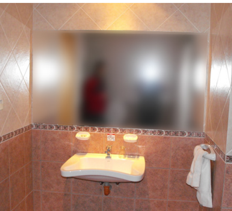
Foto : Hotel Municipal de Gdor. Gregores, Santa Cruz. Baño: un lavabo adecuado al usuario en silla de ruedas y espacio que permite la asistencia.
